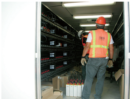
写真2 トレーラーハウスのバッテリーチャージャー 一度に480台チャージ可能
