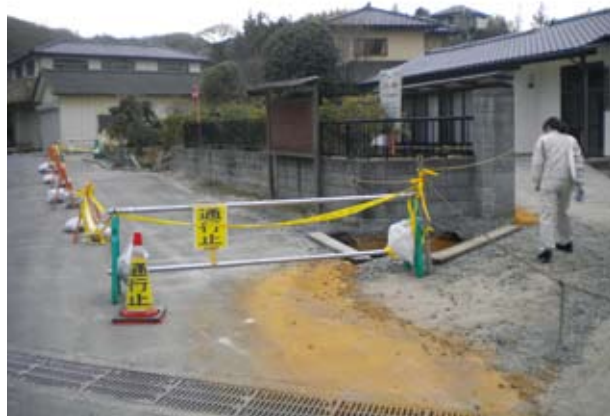
写真-3 炭坑跡地における地盤の陥没
