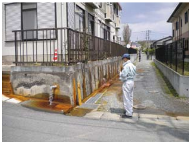
写真-2 住宅地における地下水噴出災害
